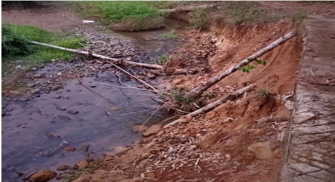
Gambar 3 Titik longsor di ruas jalan menuju RT 3 Desa Hinas Kanan (Sumber: Dokumentasi penulis, 2024)
